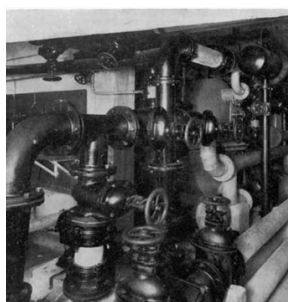
Fig. 3.25. Conjunto de la instalación de filtración y esterilización de la Isla (1931)
