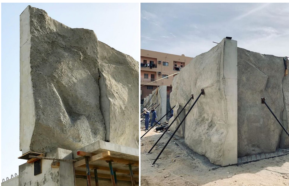
2.3.13 - 2.3.14 Montaje de las piezas prefabricadas en el Green Corner Building. Anne Holtrop, Muharraq, 2020
