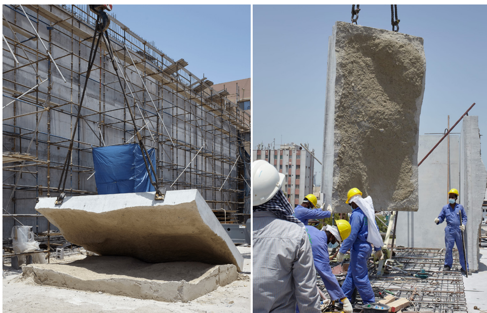
2.3.4 - 2.3.5 Ejecución de los muros prefabricados con encofrado de arena. Anne Holtrop, Muharraq, 2020
