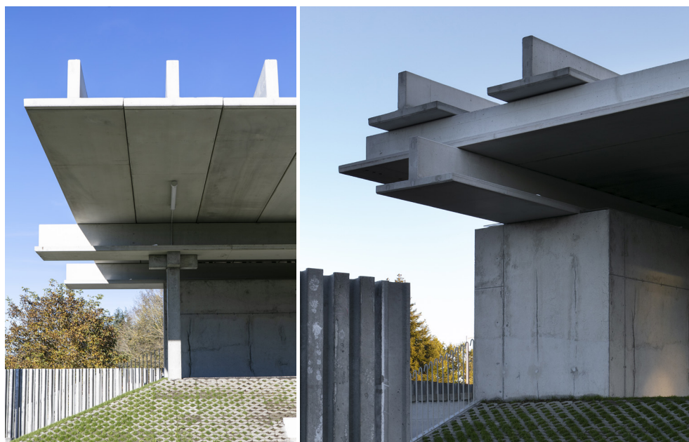
2.1.14 - 2.1.15 Detalle del apoyo de las vigas. A Gandareira, Carlos Pita y Abraham Castro, Silleda, 2018
