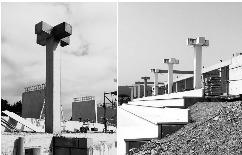
2.1.9 - 2.1.10 Construcción de los pilares. A Gandareira, Carlos Pita y Abraham Castro. Silleda, 2018
