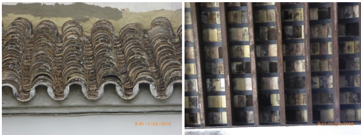
Figura 11. Detalle de cubierta, exterior con teja (izquierda) e interior sobre ladrillo por “tabla” (derecha).
