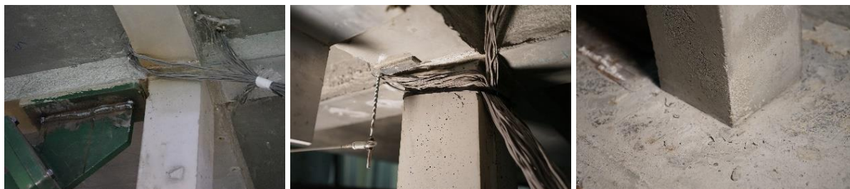
Figura 6.28: Inspección visual tras el ensayo C100.
