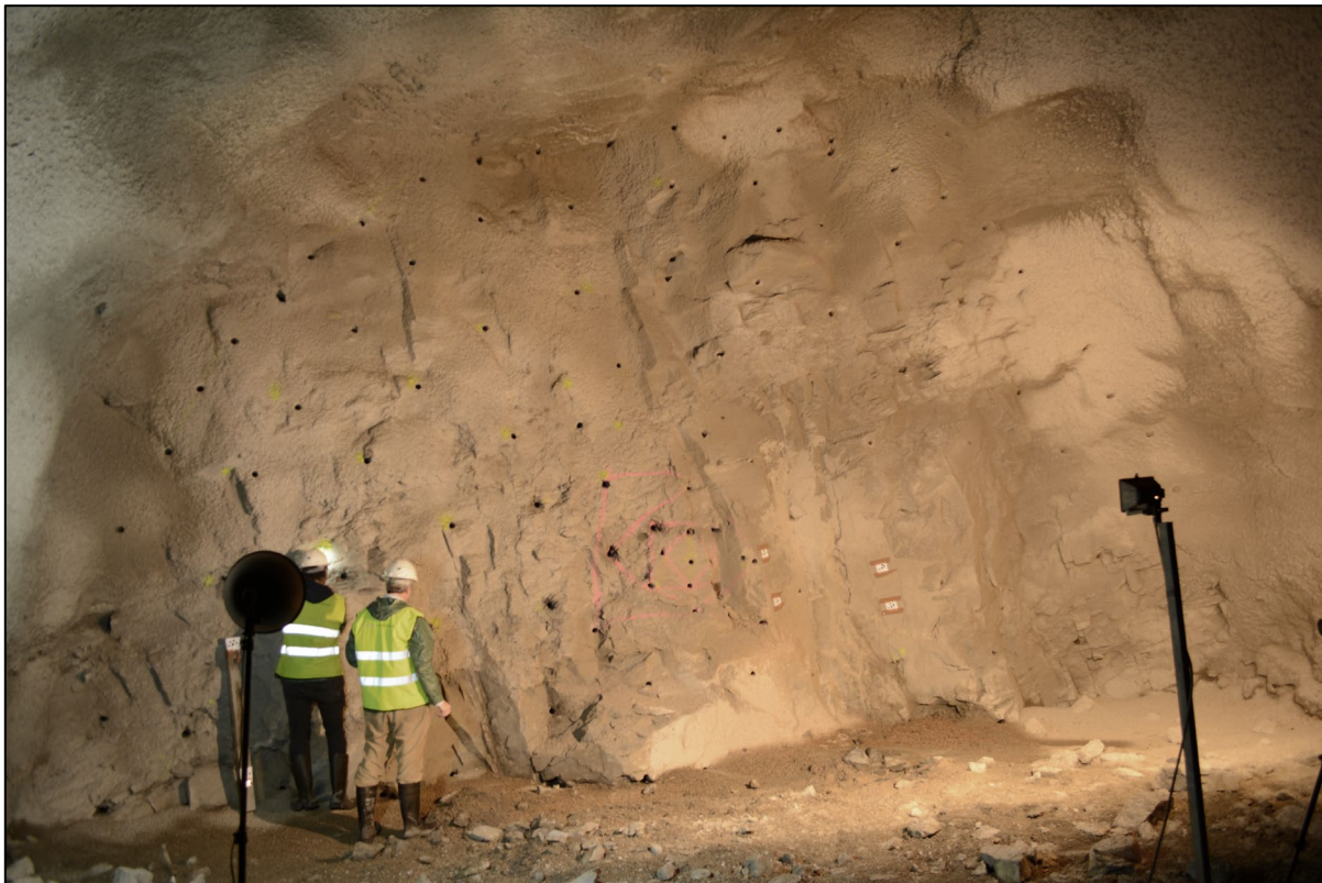
Figura 15. Imagen de campo del Túnel 1: Condiciones iniciales de iluminación y posición de los focos.
