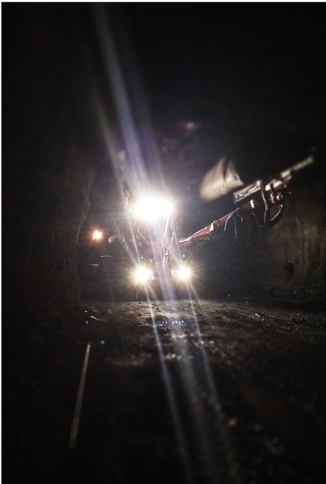
Figura 16. Imagen de campo del Túnel 2: Jumbo de perforación empleado para iluminar el frente.
