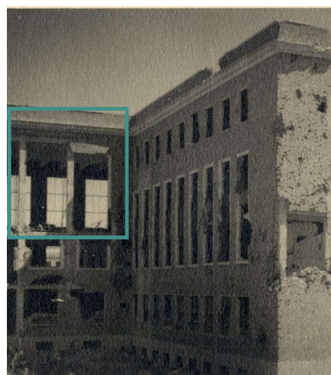
Fig.17 Daños en la estructura del Clínico. La descripción es errónea, se trata de la Facultad de Odontología. CEDEX. I-ETM-381. c.a.1939.*
