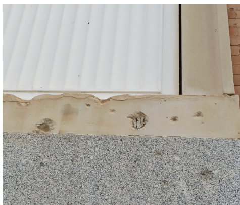
Fig. 18. Detalles de la erosión causada por los impactos de proyectiles durante la guerra. Facultad de Medicina. Fotografía propia. 2021.
