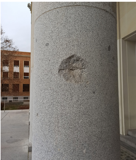
Fig. 17. Detalle de los tambores de granito de las columnas del pórtico de entrada de la Facultad de Farmacia. Fotografía propia. 2021.
