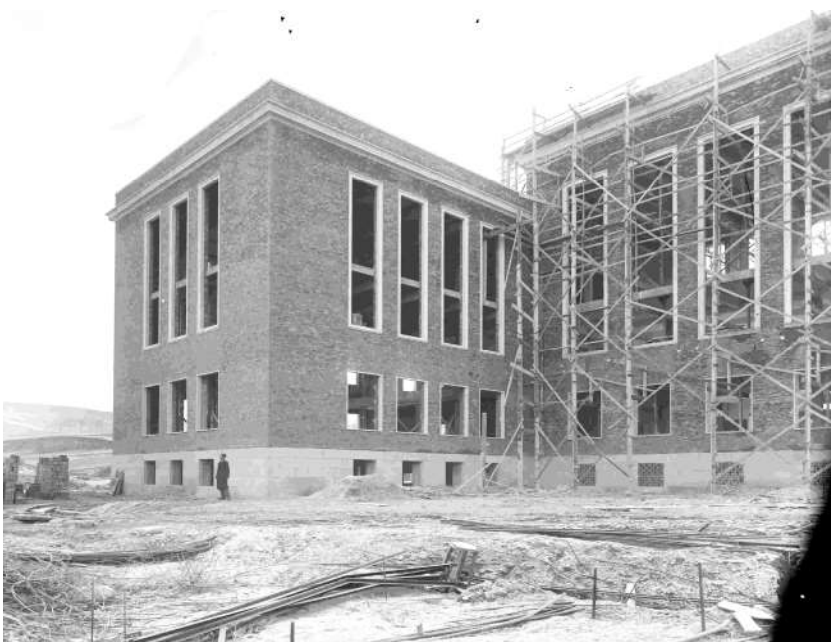
Facultad de Odontología en construcción en la Ciudad Universitaria de Madrid. Luis Lladó. Simurg. Fondos digitalizados del CSIC, ATN/LLL/0097/5525.s.f. C6.Fig. 16.
