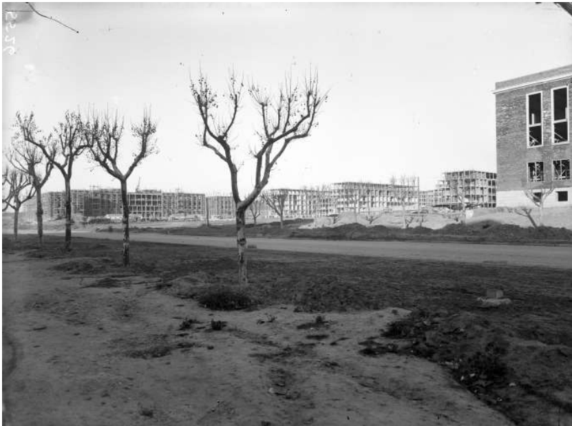
Fig. 11. Grupo médico en construcción en la Ciudad Universitaria de Madrid. Luis Lladó. Simurg. Fondos digitalizados del CSIC, ATN/LLL/0097/5526. ca. 1932. C9.Fig. 11.
