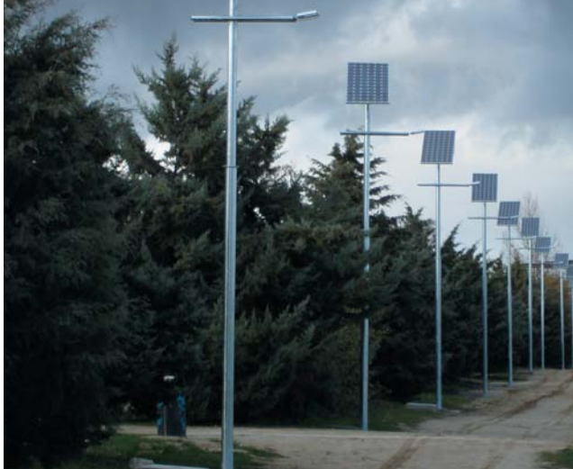
Sistema de energía solar fotovoltaica integrado en el alumbrado público
