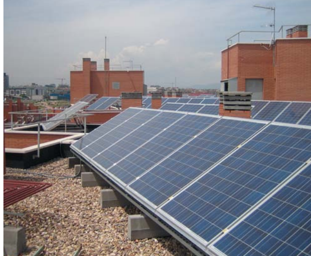
Sistema de energía solar fotovoltaica
