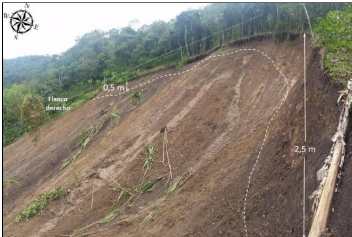
Figura 46. Detalle zona de inicio del deslizamiento
