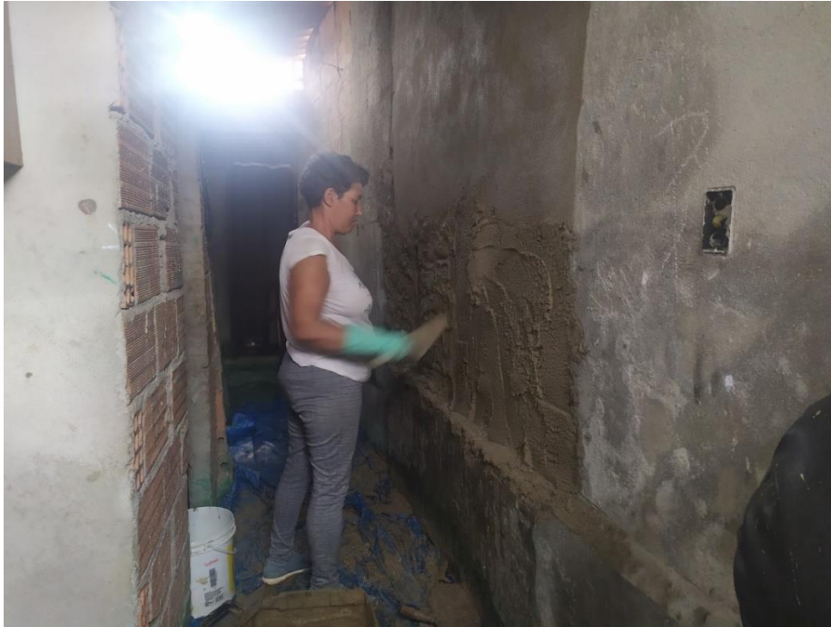
Figura 86: Nivelado para revocar utilizando la regleta y cubrimiento de la parte inferior ya enjarrada. Fotografía propia.
