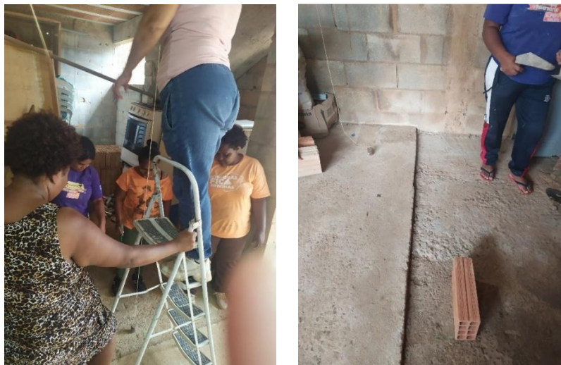
Figura79: Nivelación con plomo y desnivel entre áreas. Fotografías propias.
