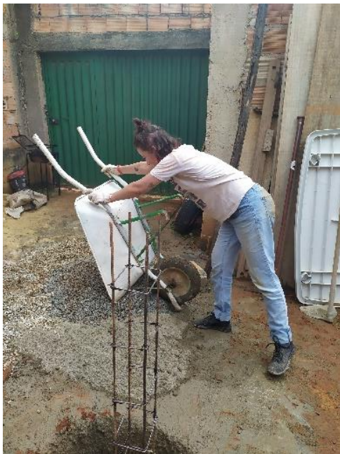
Figura 76: Ella es Jessica, una de las integrantes del equipo de arquitectas encargada de los talleres de obra.
