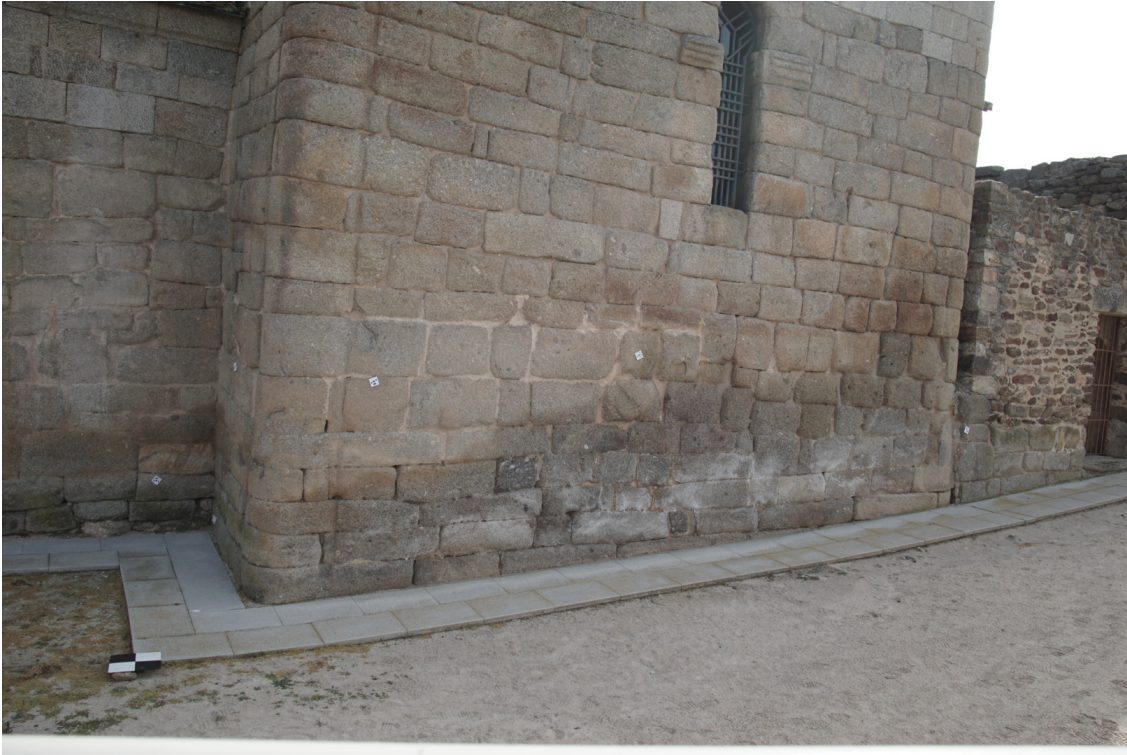
Figura 5.7: Presencia de humedad y zonas de eflorescencias en muro fachada norte en Santa Maria de Melque
