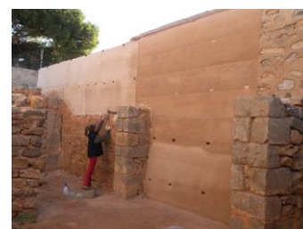
Fig. 42: Ejemplo tapia “calicostrada” Fuente: Google Imágenes
