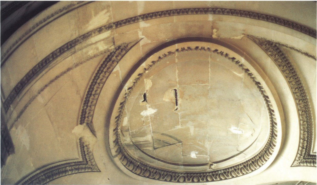
3.29. Desprendimientos en uno de los arcos formeros
