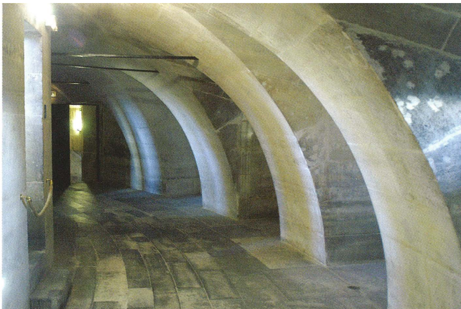
3.21. Galería intermedia entre anillos exterior e interior sobre la columnata con hierros atravesándola
