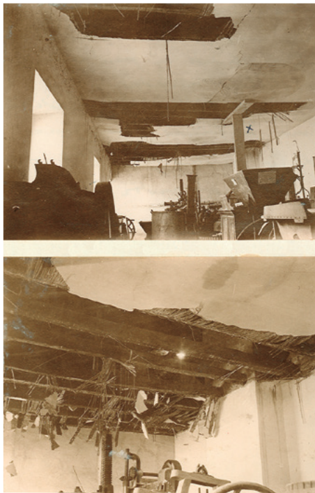
Figura 9. Fotografías del interior de la Escuela de Agrónomos del informe de Clarió, donde resulta evidente el estado de ruina. Fuente: Fondo fotográfico ETSI Agronómica, Alimentaria y de Biosistemas. UPM.
