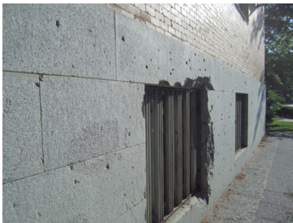
Figura 3. Impactos de ametralladora y fusilería todavía hoy visibles en la facultad de Farmacia. Fuente: fotografía de Fernando Calvo.
