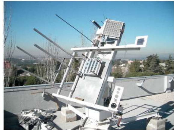
Fig. 5. Two-axis sun tracker installed on the flat roof of the Instituto de Energía Solar – Universidad Politécnica de Madrid (IES-UPM).
