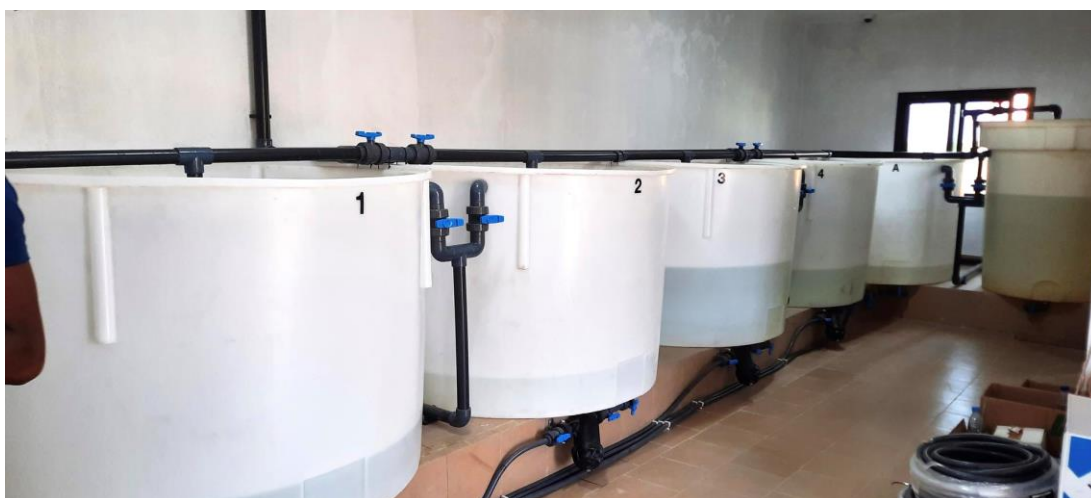
Ilustración 17 Conjunto de depósitos
