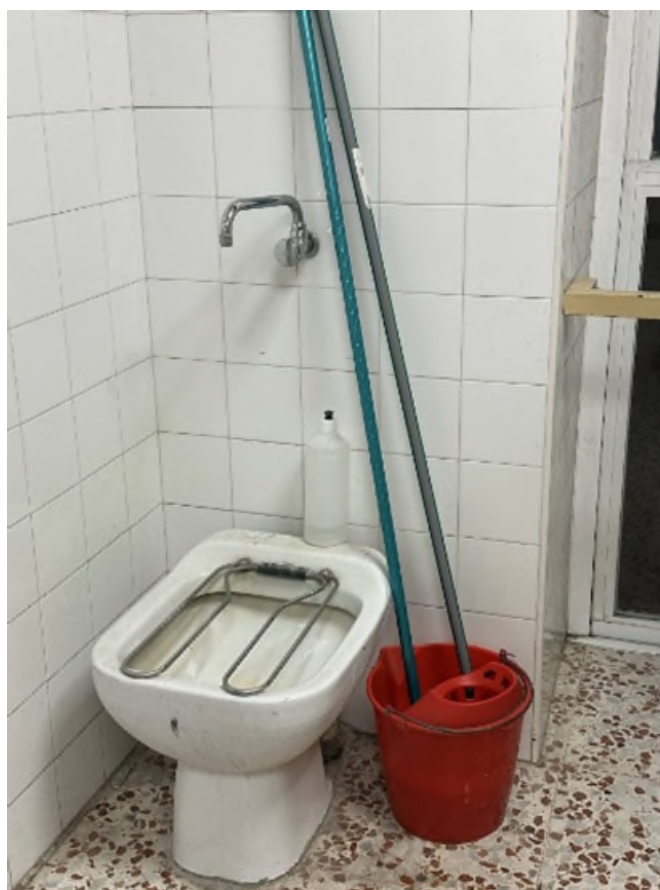
Figura 9 Uno de los vertederos empleados para rellenar los cubos de limpieza por el personal correspondiente, y su posterior vaciado, en uno de los aseos del Edificio Principal de la zona del aula.
