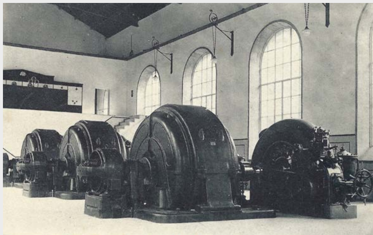
Interior de la nave de turbinas en la Central del Tambre recién inaugurada, en una postal de época. / Archivo del autor.
