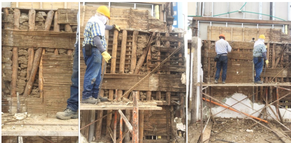
Figuras 141. Bahareques encontrados durante la demolición de la vivienda, carrera 23 (Av. Santander) con calle 47 esquina. Barrio Lleras, Manizales. Imagen de Olga Lucía Quintero, marzo de 2024.
