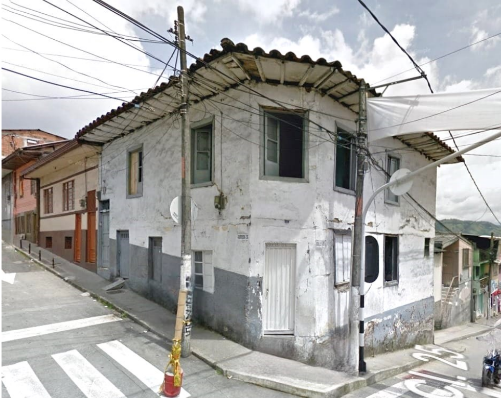
Figura 124. Vivienda localizada en la Calle 25 esquina con Carrera 26, muestra un regular/mal estado de conservación. Fuente: Google Maps .
