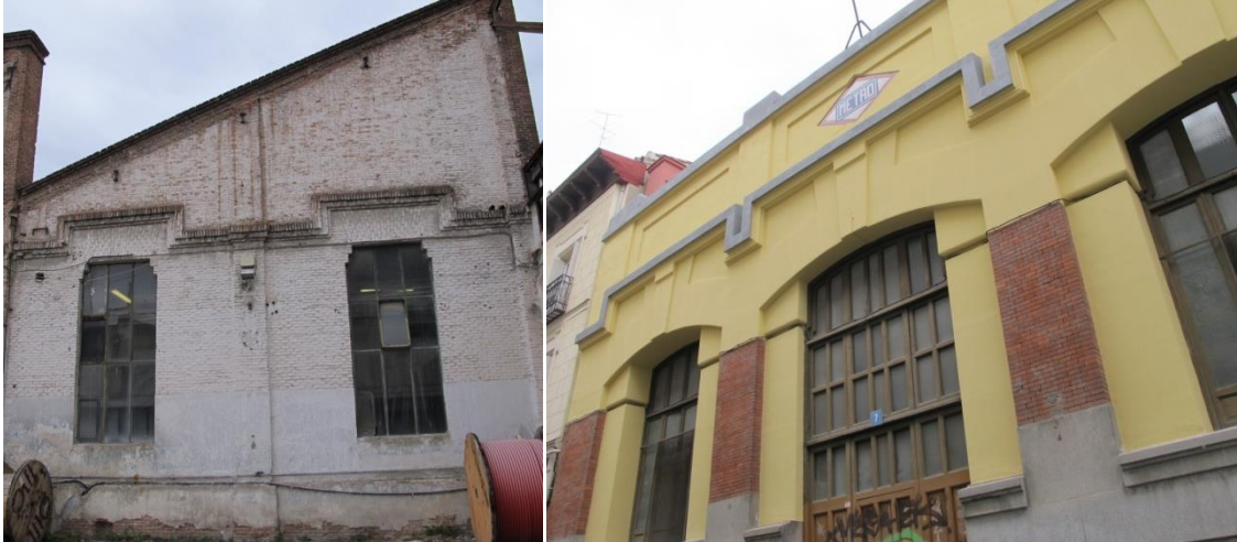
Izda: Nave central de fábrica en las Cocheras en 2015. Foto MCyP. Dcha: Subestación de Quevedo en la calle Olid en 2015. Foto MCyP.
