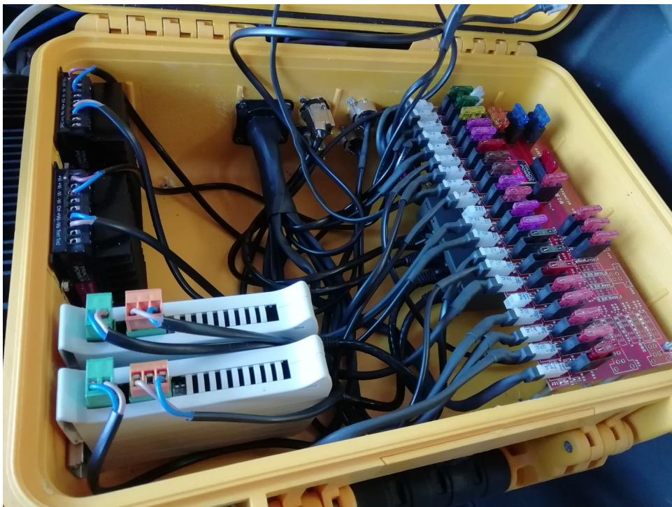
Ilustración 12: Detalle de la maleta de distribución de potencia
