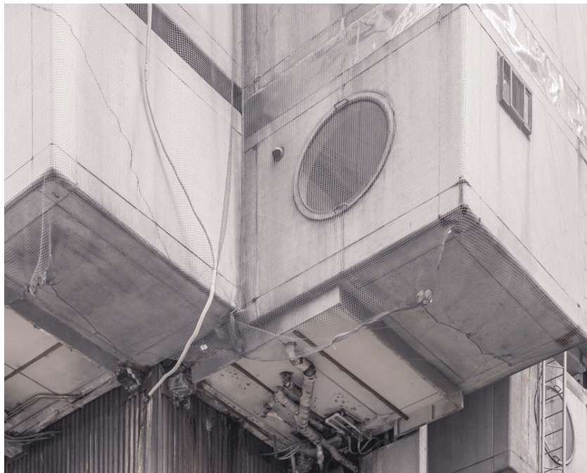
Figuras 2.1.3 / 6: Torres Nagokin Capsule Tower .Patologías de las capsulas, desagües y cables de instalaciones por el exterior.
