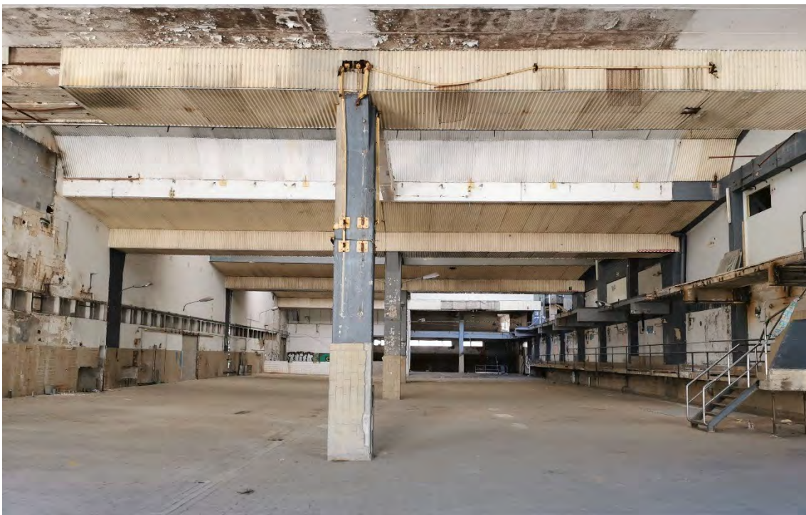
Figura 13. Interior de nave de lavado y llenado. Ausencia de barandilla superior en pasarela y de escaleras de pasarela inferior a suelo de la nave. Autor. 2023/04/04.
