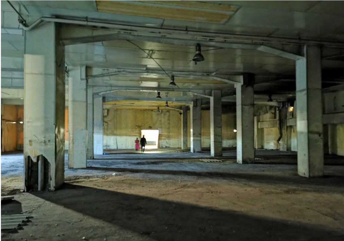
Figura A29. Almacén bajo planta de tratamientos. Fue supuestamente demolida en fecha indeterminada la entreplanta de almacén que figura en los planos de sección. Autor. 2023/04/04.
