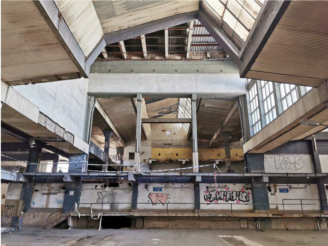
Figura A21. Vista desde nave de producción hacia torre de esterilización. Falta viga en cubierta de la torre. Autor. 2023/04/04.
