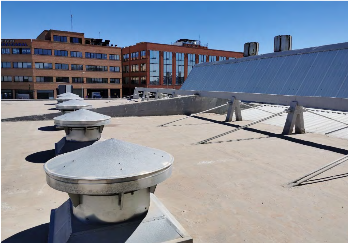
Figura 13. Cubierta de nave de producción en su zona norte con nueva impermeabilización, parte sobresaliente de la estructura y nuevo revestimiento de placas onduladas traslúcidas en lucernarios. Los extractores en primer plano no son originales. Sí en cambio los dos sobre los lucernarios.
