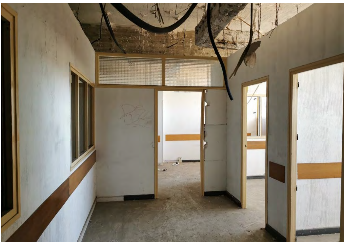
Figura 16. Interior zona oficinas con eliminación de falsos techos. Faltan también las hojas de las puertas. Autor. 2023/04/04.
