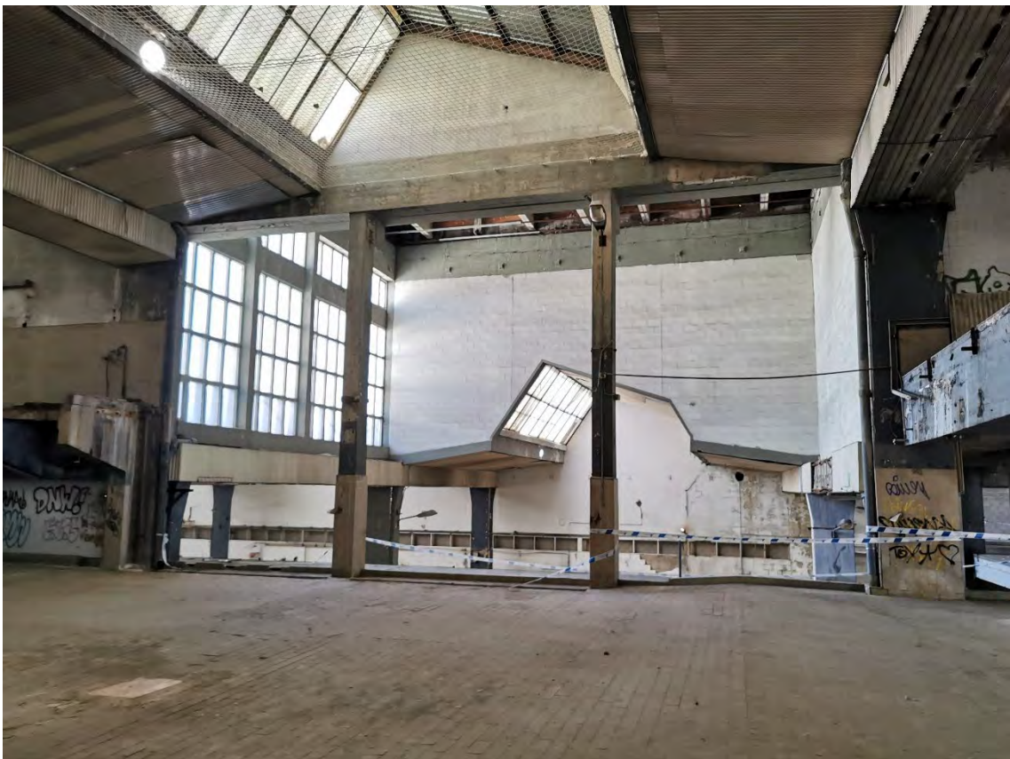
Figura A22. Vista desde lado opuesto a la anterior. Falta cielo raso en cubierta lucernario. Autor. 2023/04/04.
