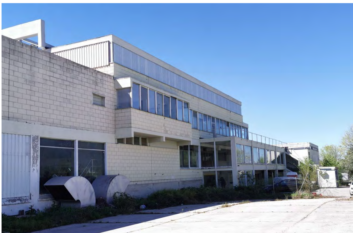
Figura 13. Estado actual de la fachada norte. Colocación de planchas onduladas traslúcidas sobre franja de carpinterías de planta segunda y opacas en ventanal planta baja (izda.). Autor. 2023/04/04.
