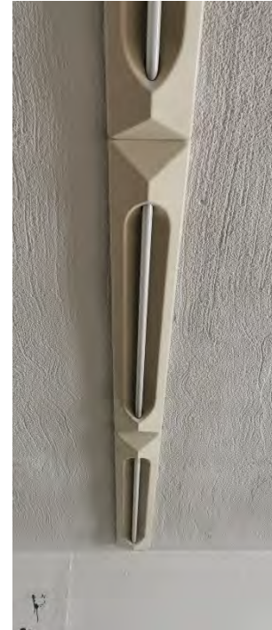
Figura A38, Luminaria fluorescente de plástico existente en techos de oficinas. Autor. 2023/04/04.
