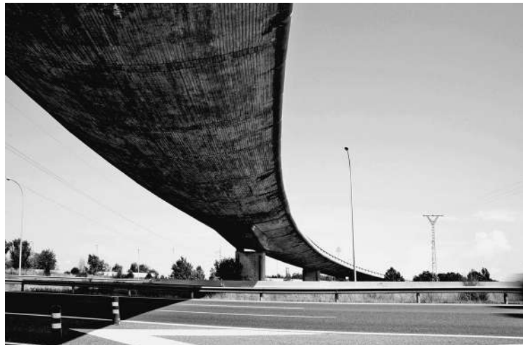
Vista tableros superiores
