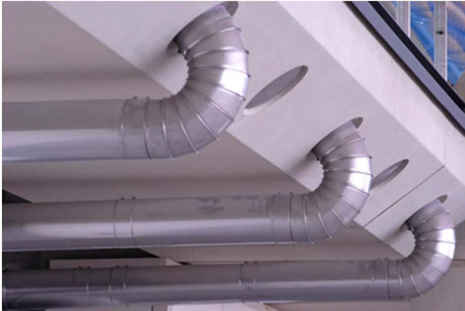
Ilustración 66. Zoom Exterior. Sistema Perimetral de CLimatización
