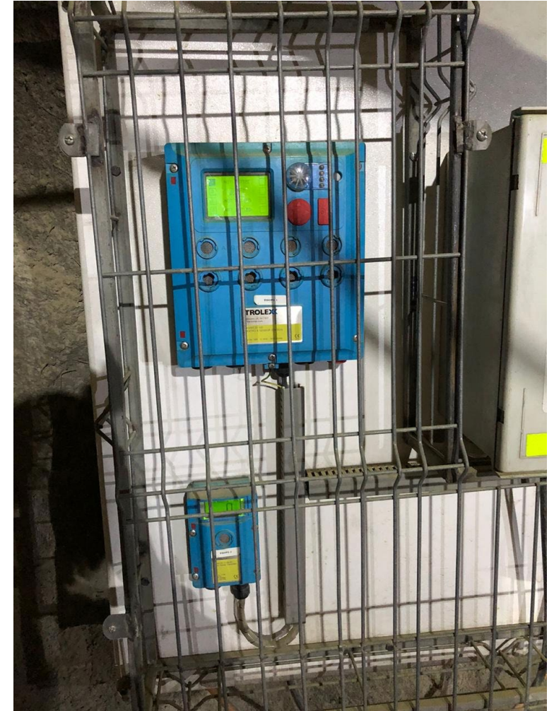
Sistema de monitoreo de gases Fuente: https://hcamineria.cl/
