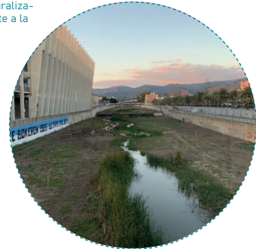
4. Mal estado de mantenimiento del tramo renaturalizado
