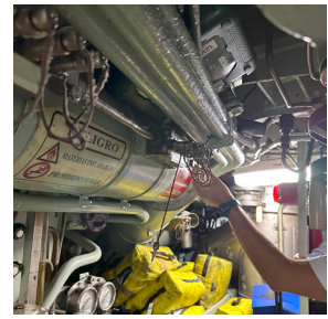
Figura 3.3.4. Imagen del sistema de emergencia para conectarse a los conductos de oxígeno
