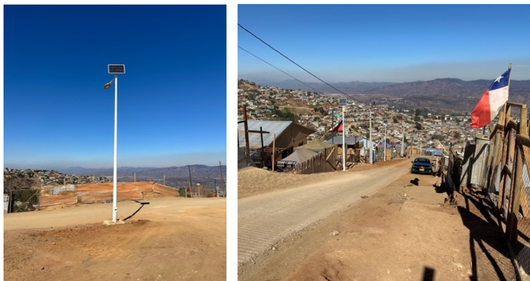
Figura 6-11 Obras de alumbrado público solar, Campamento Manuel Bustos, Viña del Mar
