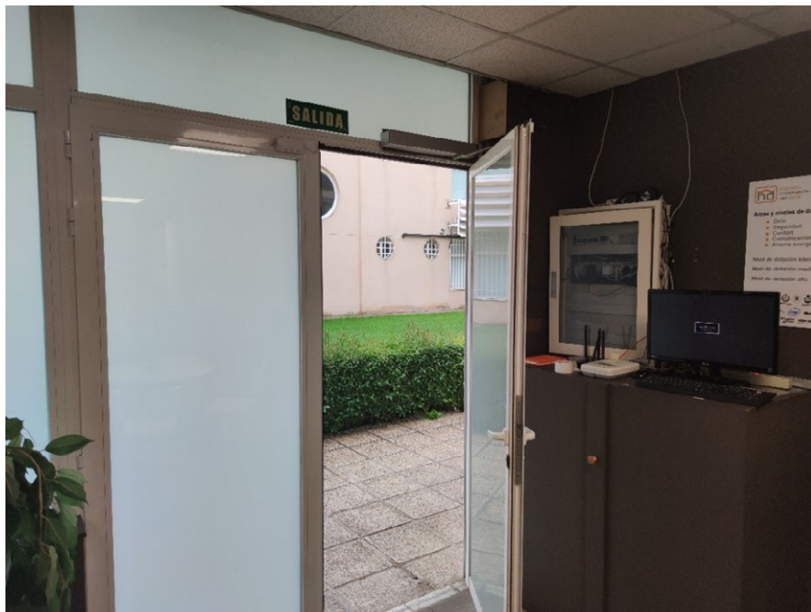
Figura 22: Instalación de sensor Open Close en puerta principal
