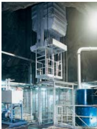
Skip con plataformas inferiores de inspección (Fuente: ABB).
