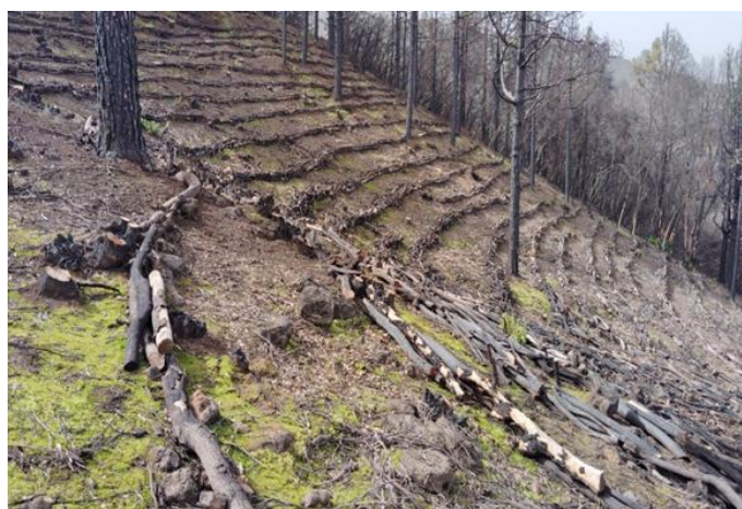
Figura n.º 51. Detalle de fajinas en ladera siguiendo curvas de nivel. Elaboración propia.
