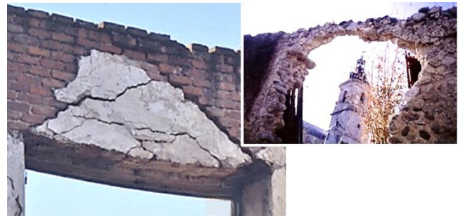
[12] una tabla por todo dintel. Grietas formando arcos
