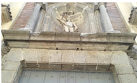
[25] Madrid, iglesia de san Sebastián, cuñas sobre el dintel
