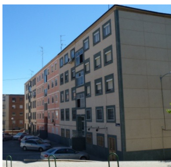
P.D. Canillas. Variedad de revestimiento en un mismo bloque. VCB-2B, 2012 (Fotografía de la autora)
