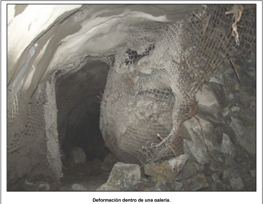
Deformación dentro de una galería.
