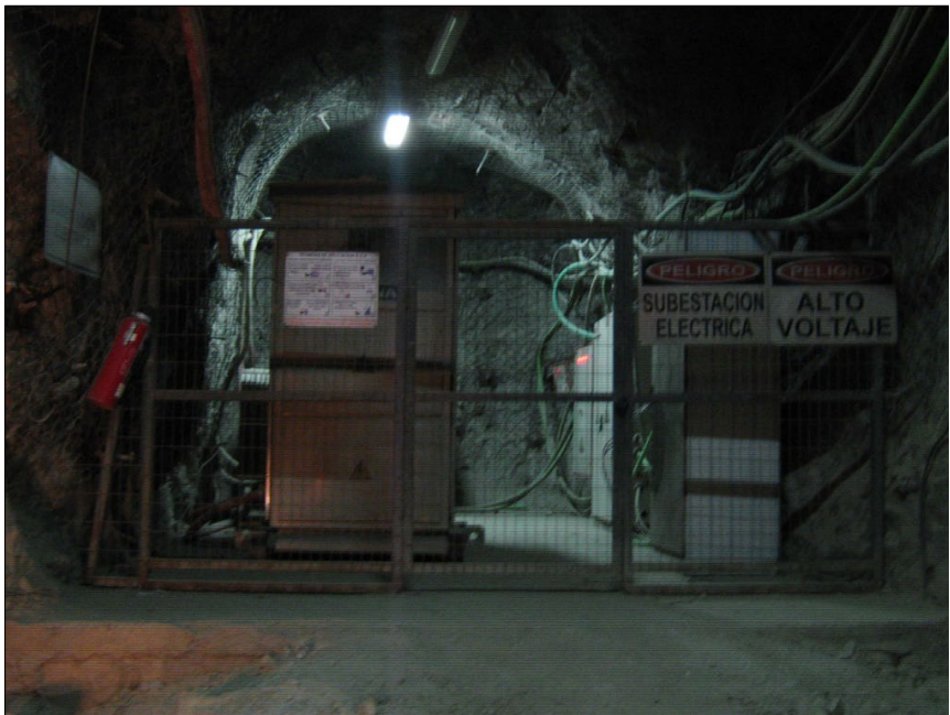
Subestación eléctrica en mina de interior
