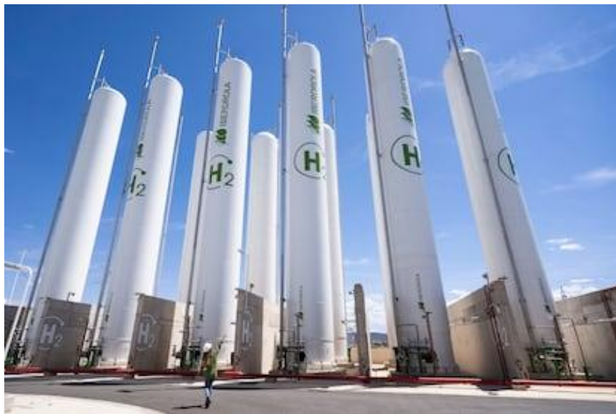
Figura 3-4: Tanques de hidrógeno de la planta de Iberdrola en Puertollano [15]
