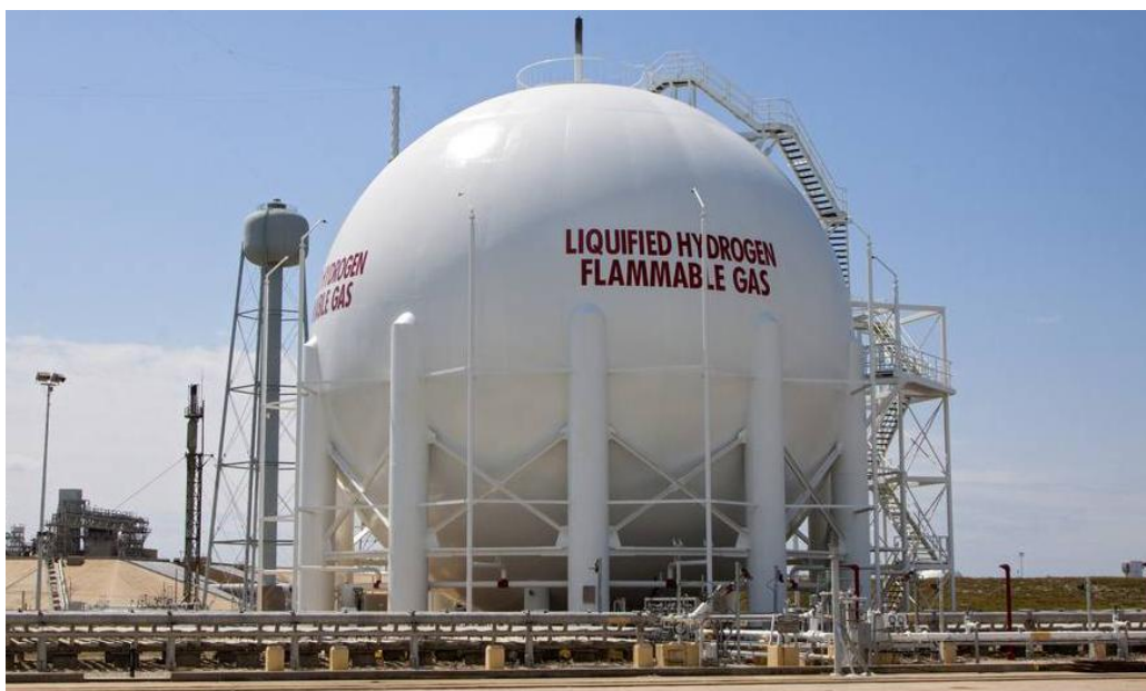
Figura 3-6: Depósito esférico de hidrógeno líquido [16]
