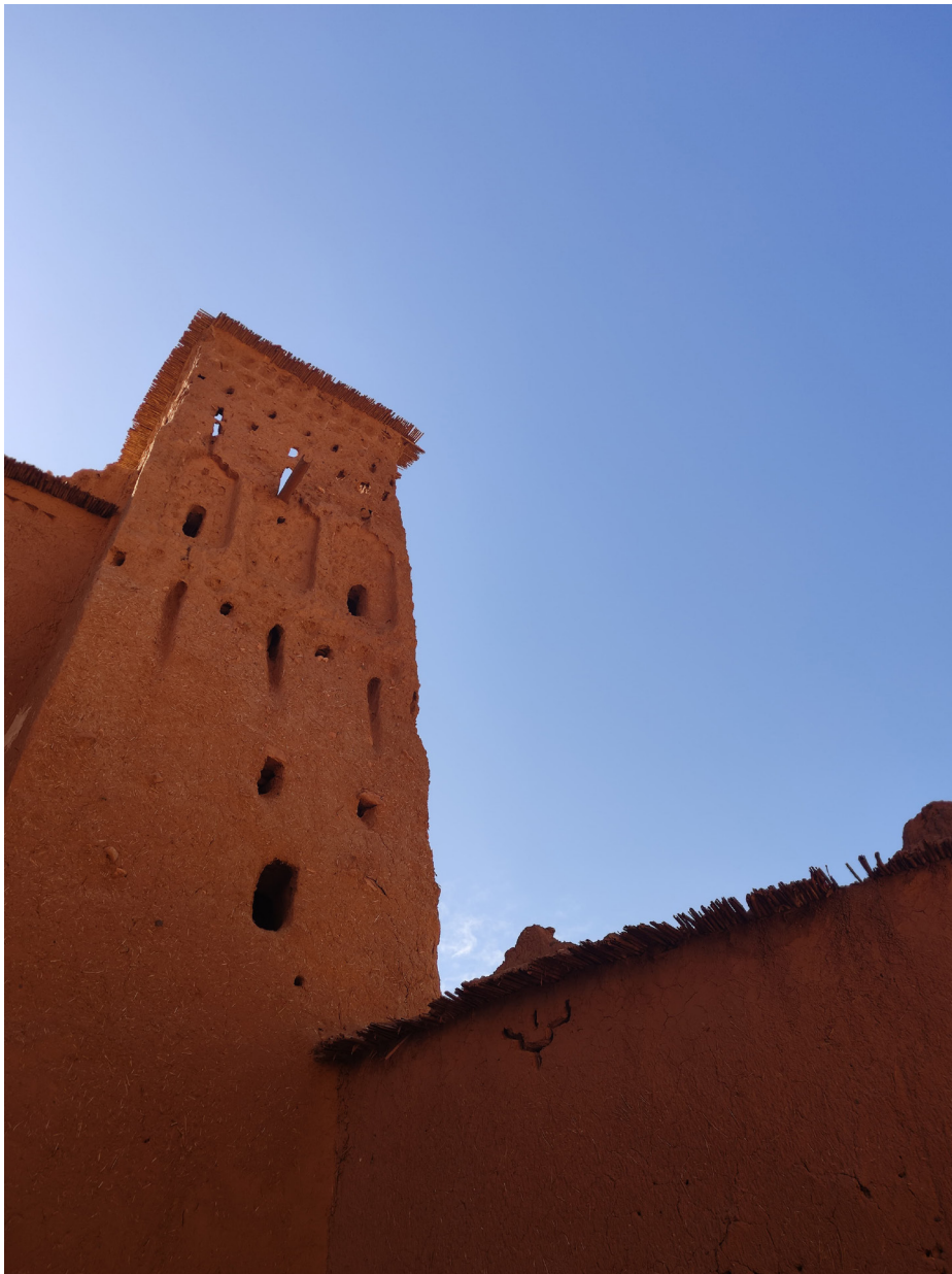
2.22. Torre dentro de un ksar. Acabado de paja sobre muros. (Elaboración propia)
