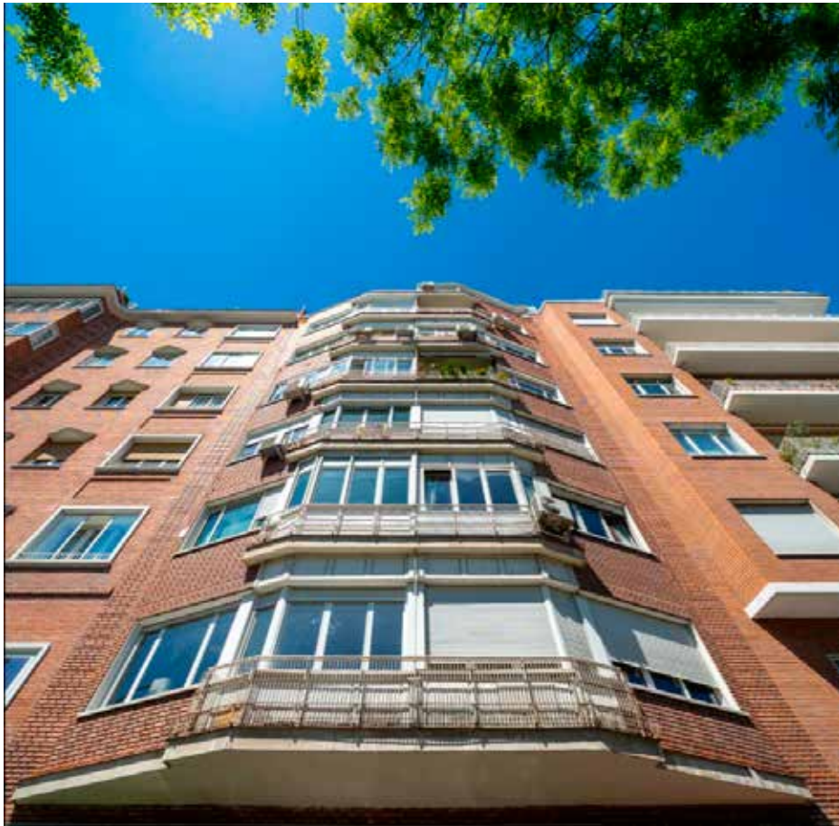
2.8 Estado actual de las terrazas de Juan Bravo con cerramiento de carpinterías en la hoja exterior-calle.
