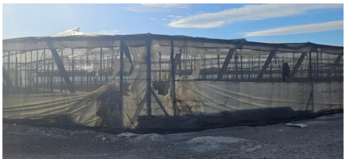
Imagen D – Invernadero en mal estado
