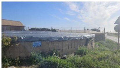
Depósito de agua Elaboración propia
