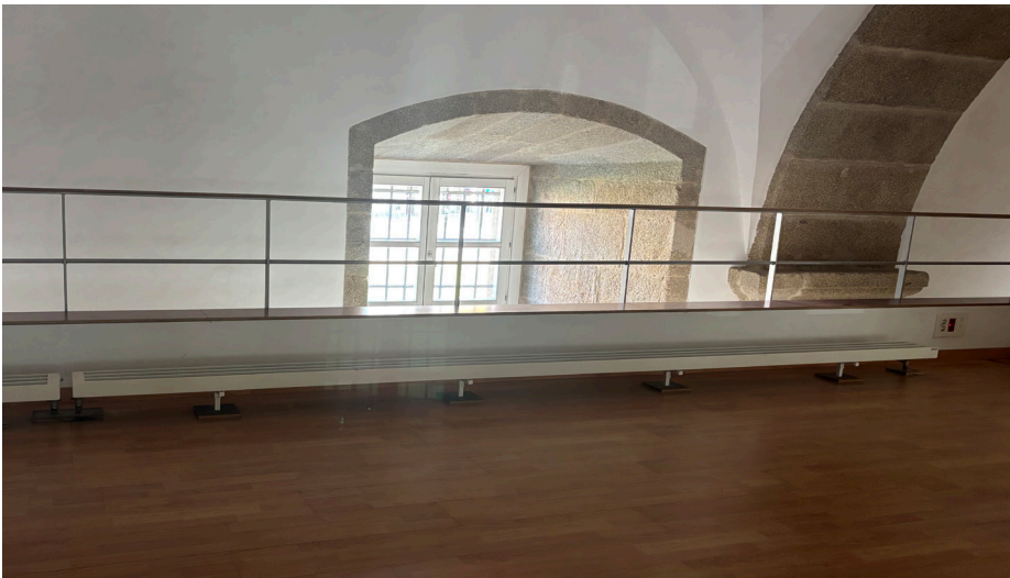
2.1.31. Imagen de los radiadores de la entreplanta. (2025)
