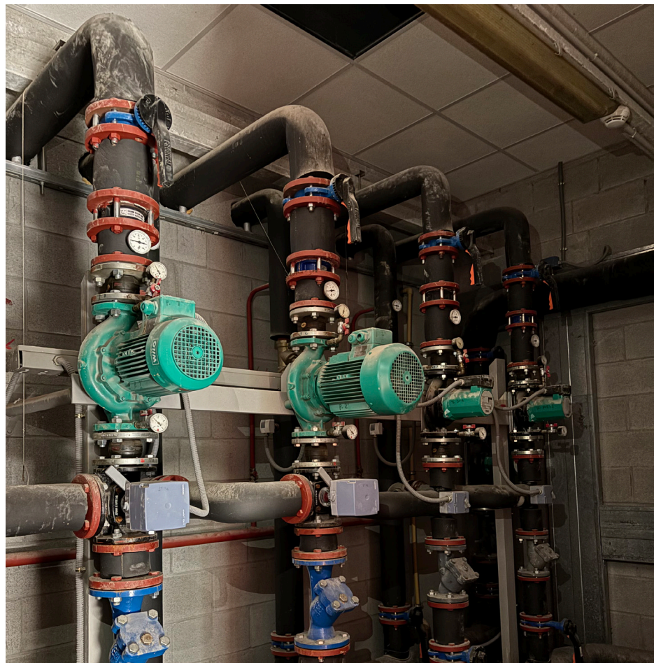
2.3.25 Imagen de las bombas de la sala de producción de Las Herrerías (2025)
