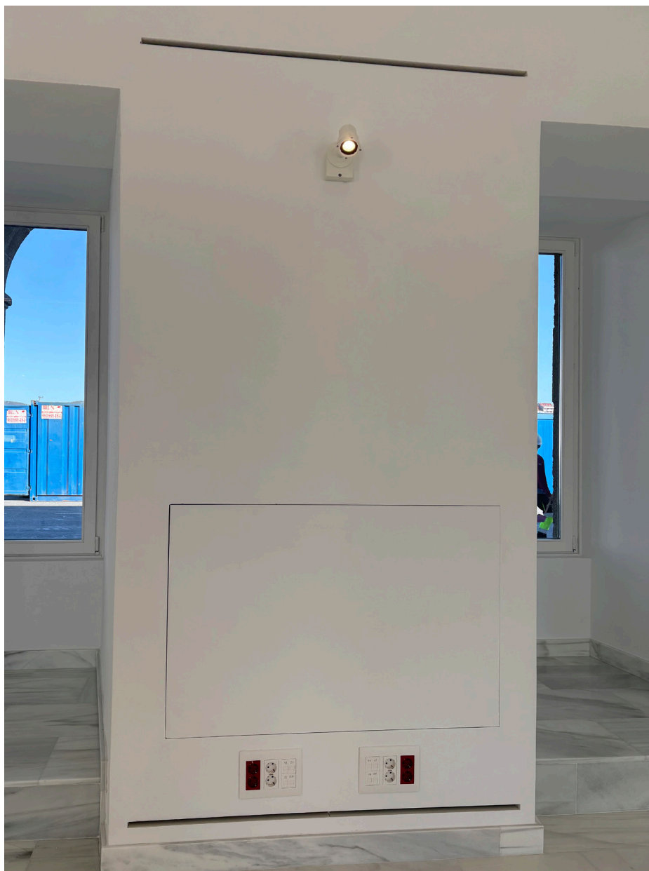
2.2.37 Imagen de la climatización oculta en planta baja. (2025)
