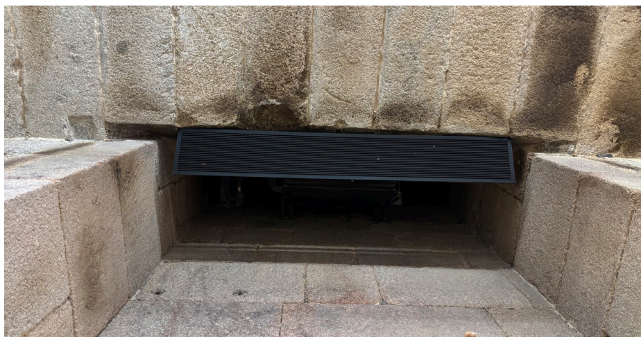
2.3.28 Imagen de la vista del fan-coil situado en las antiguas chimeneas (2025)
