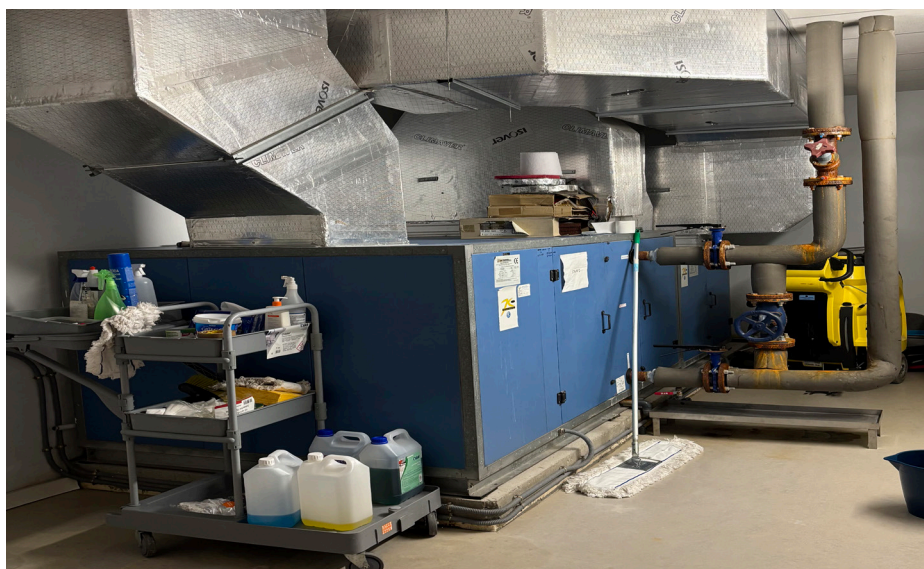
2.1.33. Imagen de una unidad de tratamiento de aire de la planta primera. (2025)
