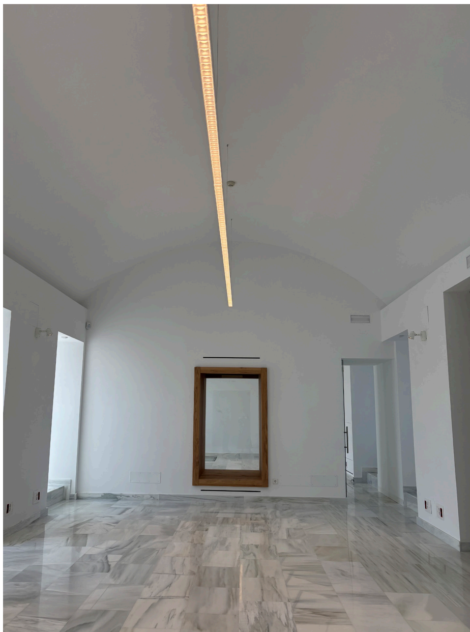
2.2.38 Imagen de la climatización oculta en planta baja. (2025)
