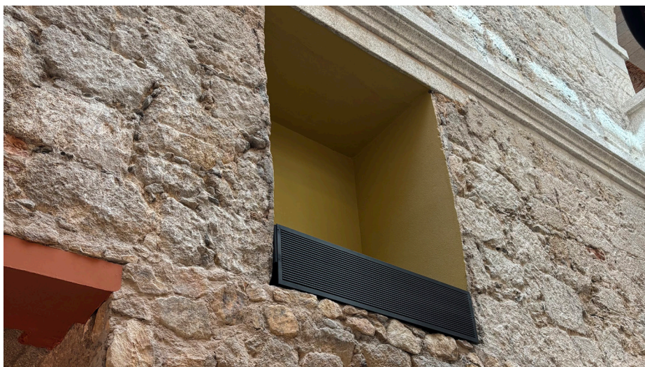
2.3.27 Imagen del fancoil situado en la planta baja. (2025)
