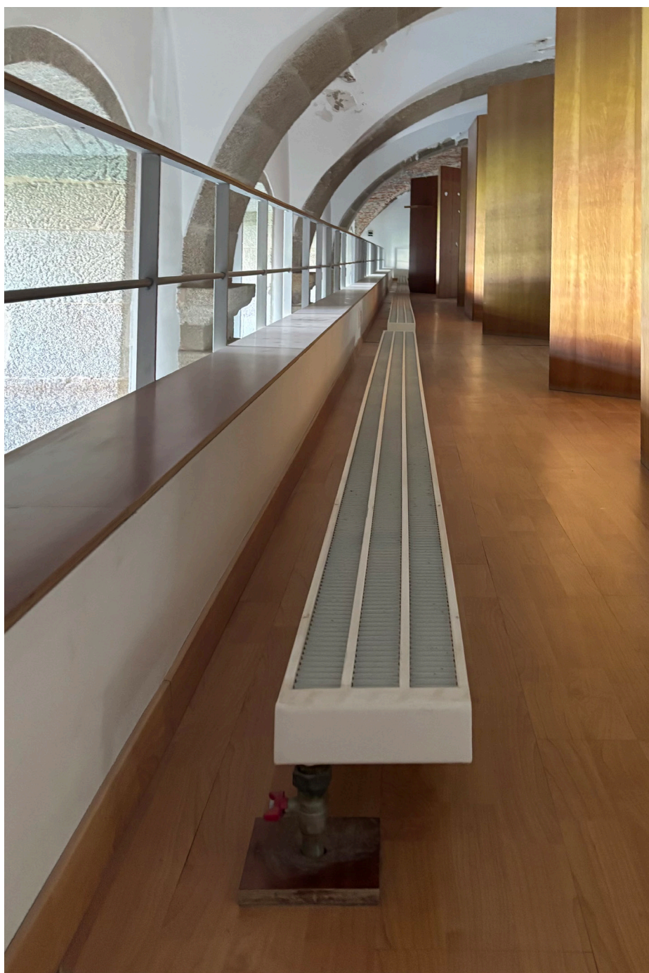
2.1.40. Imagen de los radiadores de la entreplanta. (2025)
