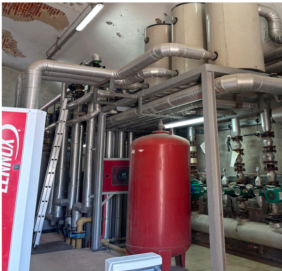
2.1.29. Imagen de la sala de calderas de la Sala de Armas (2025)
