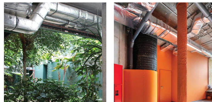
Figura 6.41: Conductos de ventilación visibles en el jardín central (izq).
