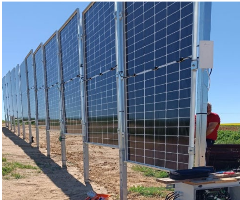
Figura 3 Sistema de paneles bifaciales verticales instalados en Zamora, España.
