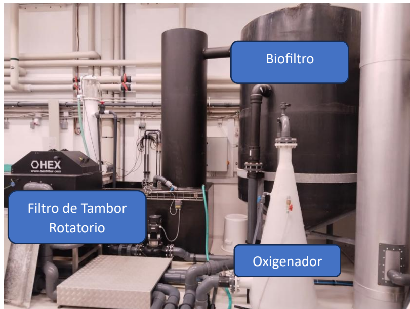
Ilustración 8: Sistema de Recirculación de Acuicultura (RAS), edificio principal de acuicultura, acoplado al sistema acuapónico. Foto de elaboración propia.
