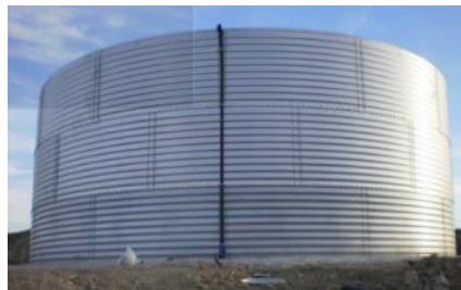
FIGURA 32: IMAGEN DEPÓSITO DE AGUA EN LA PLANTA
