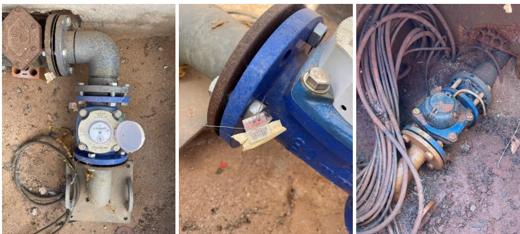
Figura 6 Caudalímetros de cada uno de los pozos.
