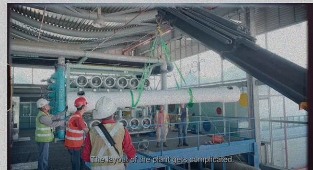
Ensamblaje de la infraestructura modular de ósmosis inversa. Fuente: Our NEWater Journey, 2024.
