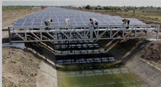
Paneles solares instalados sobre el canal Narmada, en el pueblo de Chandrasan, Gujarat, India. Fotografía: Ajit Solanki 2012. [Fig. 117]
