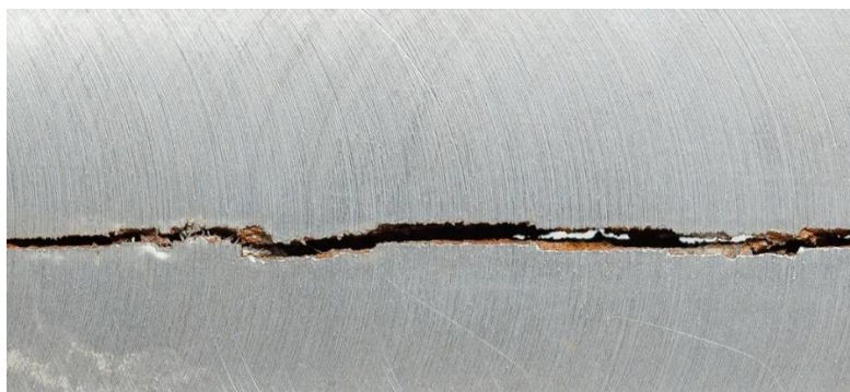
FIGURA 17: GRIETA INDUCIDA POR HIDRÓGENO (HIC)
