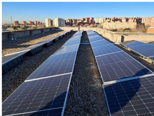
Ilustración 21. Instalación fotovoltaica en cubierta del edificio de la ETSIGCT. Fuente: Elaboración propia
