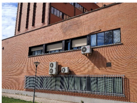
Ilustración 18. Unidades exteriores de equipos de refrigeración en todas las fachadas del edificio de la ETSIGCT. Fuente: Elaboración propia
