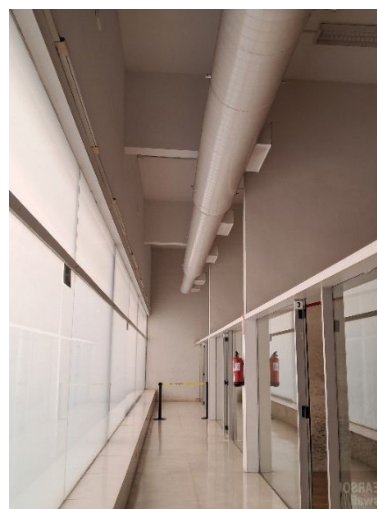
Ilustración 38. Conductos de ventilación mecánica salas de squash. Polideportivo. Fuente: elaboración propia
