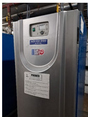
Ilustración 16. Sala de calderas del edificio de la ETSIGCT. Fuente: Elaboración propia
