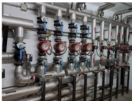
Ilustración 17. Sala de calderas del edificio de la ETSIGCT. Fuente: Elaboración propia
