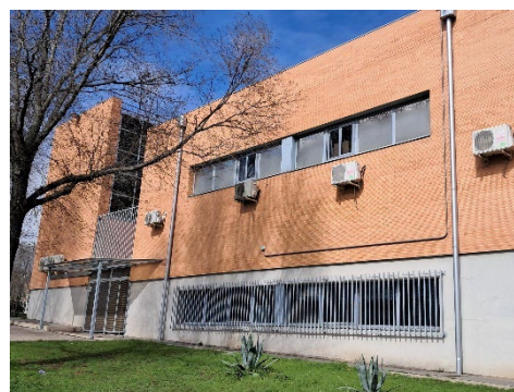
Ilustración 20. Unidades exteriores de equipos de refrigeración en todas las fachadas del edificio de la ETSIGCT. Fuente: Elaboración propia
