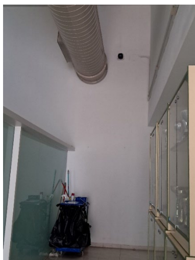
Ilustración 37. Conductos de ventilación mecánica salas de squash. Polideportivo. Fuente: elaboración propia
