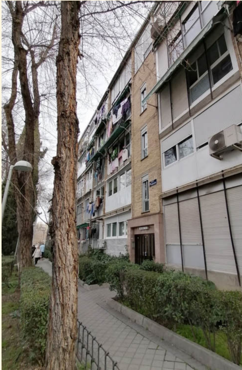
Poblado Dirigido de Fuencarral: Fachadas originales con los cambios relativos al cierre de las terrazas y la instalación de equipos de aire acondicionados.
