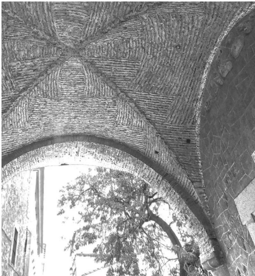
Figura 4 Aparejo de ladrillos en la arista del Arco del Socorro en Cáceres (fotografía de los autores, 2022)
